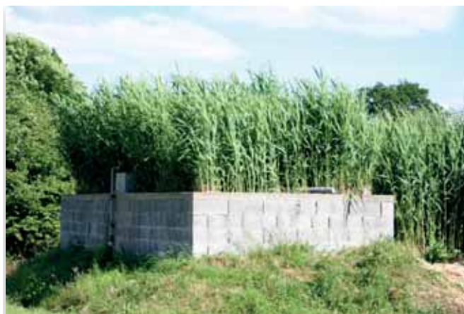
Photo 33 : Le traitement des effluents par les roseaux
