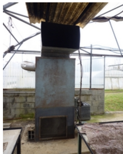
Chauffage au fioul à air pulsé
